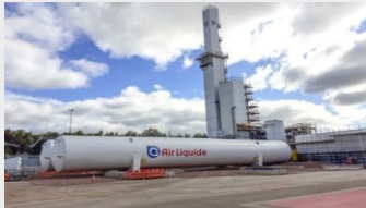
300 KL and 500 KL tanks
