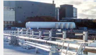
1,000 m³ Mini LNG Terminal
